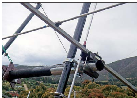
Bild 8: Spiderbeam-Rohre dienen als Abspannturm
