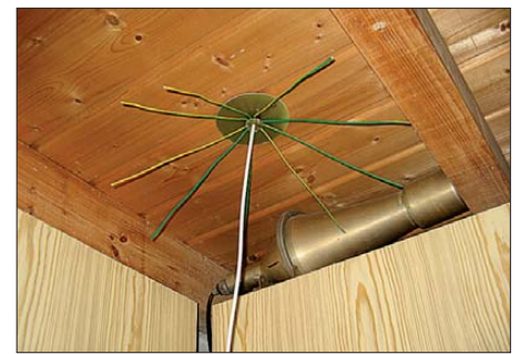
Bild 4: Ansicht der an der Zimmerdecke befestigten Antenne; der rohrförmige Gegenstand ist ein Abschlusswiderstand aus den 1970ern und gehört nicht zur Antenne.
